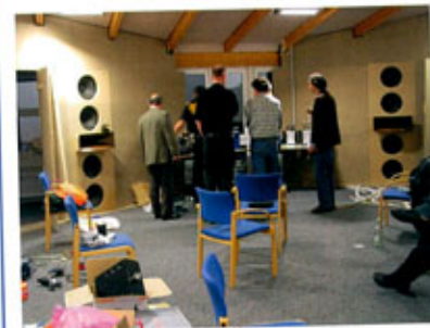
初日のセッティング風景。このように両サイドをそのままエンクロージャーに仕立て上げてしまった部屋もある。これだけ大掛かりな作業を軽くこなしつつ、まるで違和感なく収めているところがすごい!
